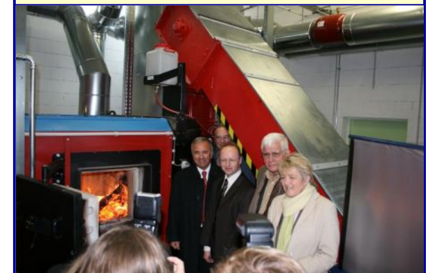
Inbetriebnahme Holzhackschnittelkessel, 830 kW
