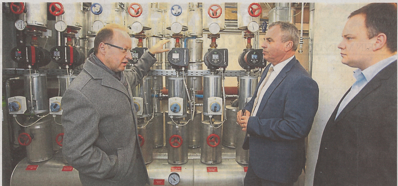
Über die Vorteile der neuen Heizkreispumpen im Keller des VG-Rathauses sprechen EDG-Geschäftsführer Christoph Zeis (l.), Bürgermeister Robert Scheurer (Mitte) und Klimaschutzmanager Markus Forschner. Foto: hbz/Judith Wallerius
