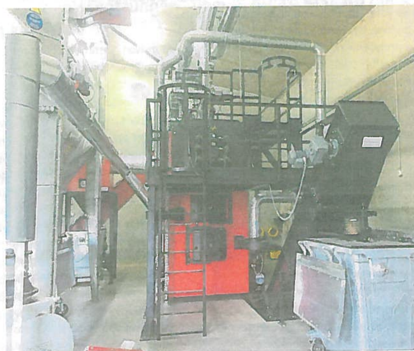
Biomassefeuerung, E-Filter und Ascheabfuhr
